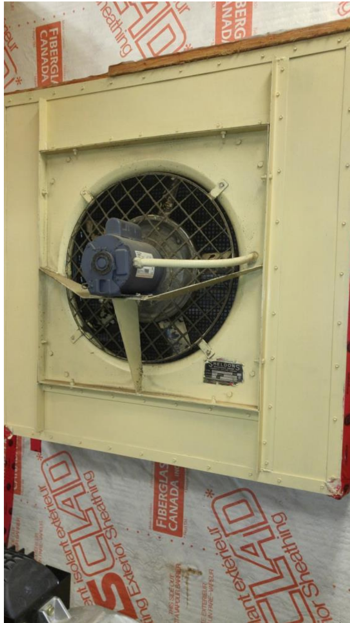
ID01_M01: Generator Room Exhaust Fan
